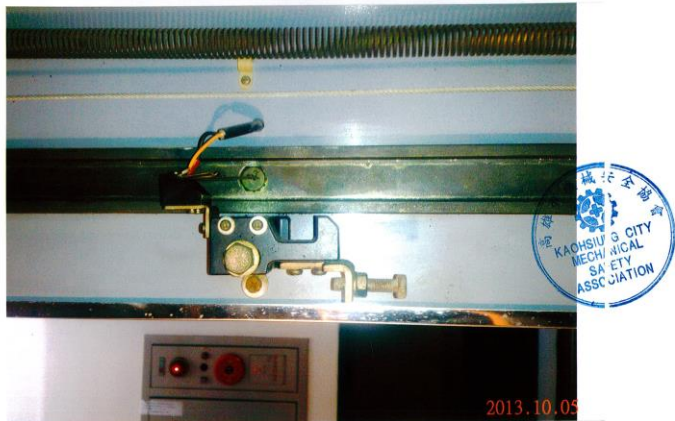
電梯門打開後電氣接點開路，電梯不能啟動。
